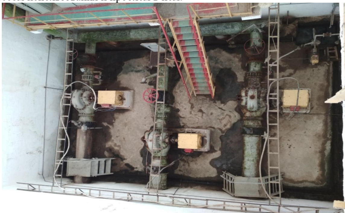
Рисунок 1: Минутная часть сливной насосной станции и расположена в нем Корпус насосных единиц [2].
